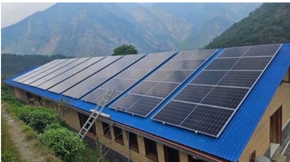
Projet panneaux solaires de l'hôpital
